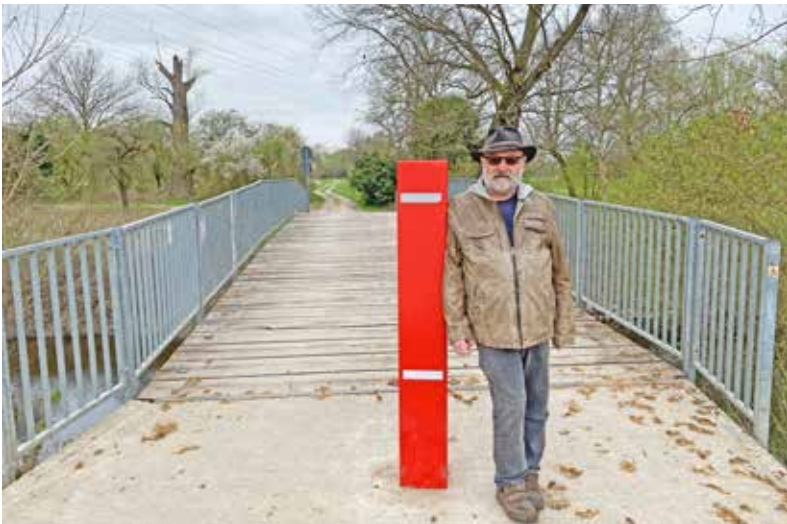
Hubert Hübner und der rote Pfosten, der die Nutzung der Brücke verhindert.
