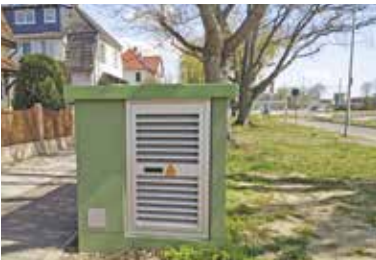
Trafohäuschen statt Schallschutz
